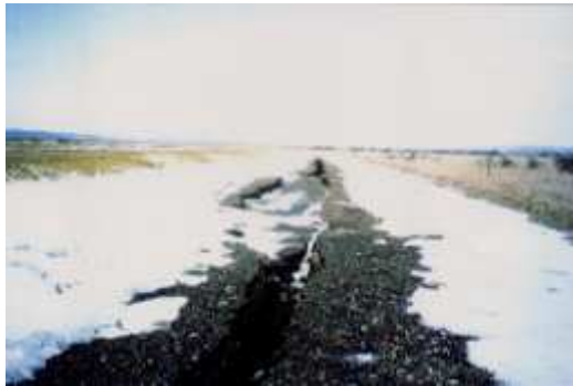
写真 2.1 釧路沖地震の被害状況（無処理）
