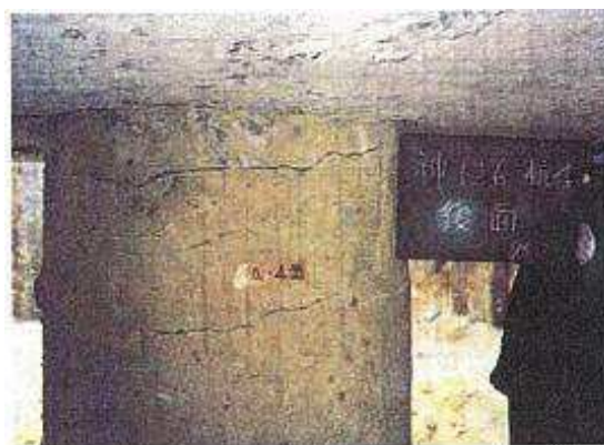
写真 4.1 基礎杭の損傷状況 ③
