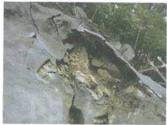
写真 3.1 老朽化した法面の状況
