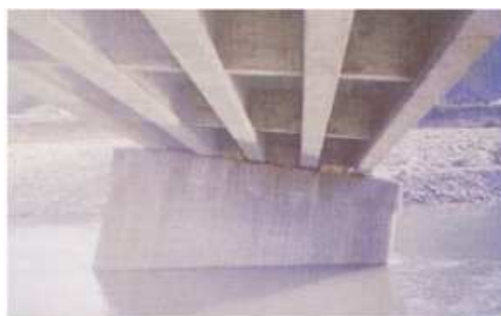
写真 4.2 洗掘による橋脚の沈下
