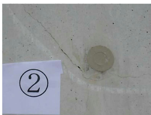
(f) 施工後のひび割れ状況
