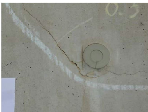
(e) 施工前のひび割れ状況
