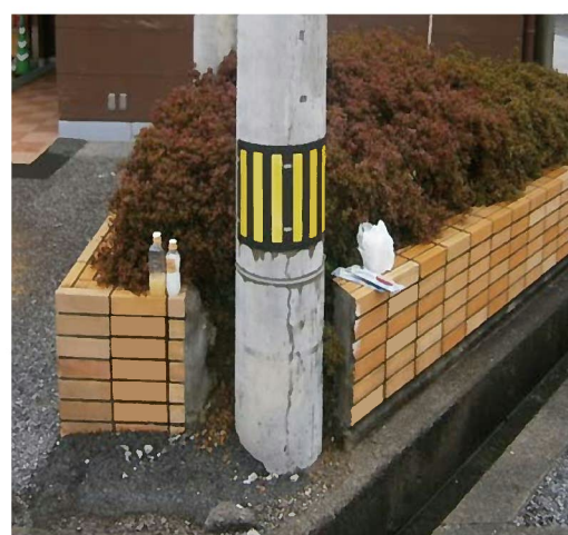
写真-2.1 電柱へのひび割れ発生状況 (電柱の基部に軸方向のひび割れが生じている。)
